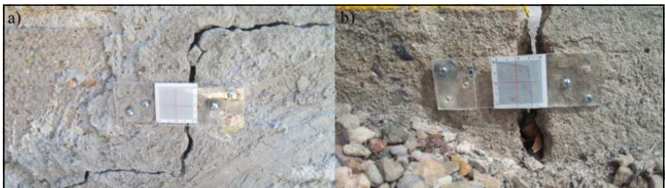
Figura 2. Ejemplos de dos fisurómetros (p-10 (a) y p-17 (b)) y su colocación en las diferentes estructuras dentro de la población. Fotografías tomadas por los autores.
